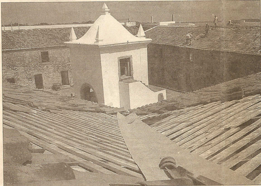
ATRASO A reforma, que inclui o retelhamento do prédio, sofreu atraso por causa das chuvas
